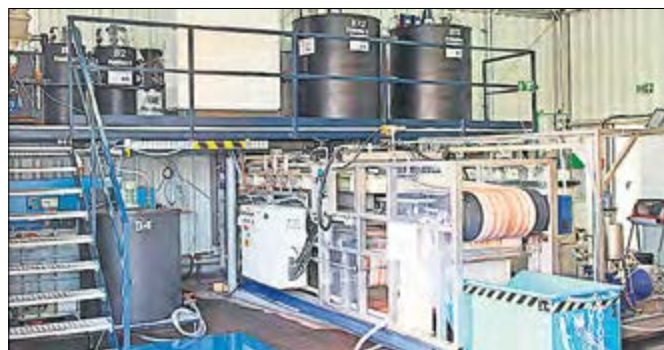
Die Hamburger Pilotanlage ging am 6. Juli 2015 in Betrieb. Foto: REMONDIS
